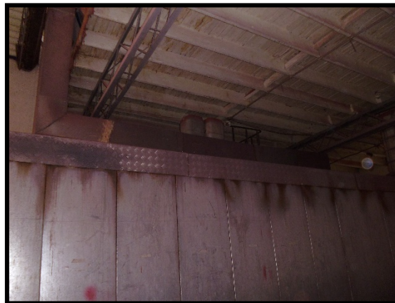
Foto 8. Ducto de descarga
