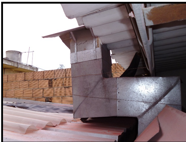
Foto 9. Descarga de emisiones provenientes del horno de secado sobre el tejado
