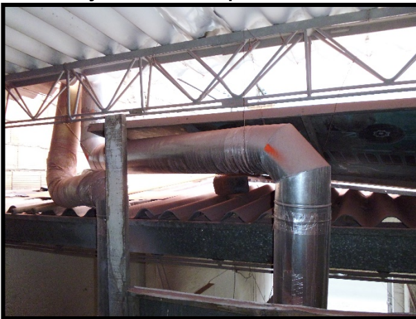
Foto 5. Ductos descarga cabinas
